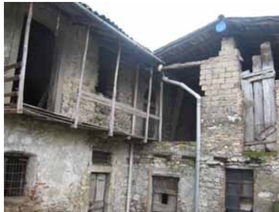
Figura 10.2: Edificio storico in stato di abbandono (Borgo di Terzo)
