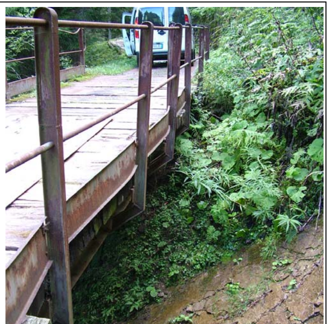
Foto 2. Ponte con sezione di deflusso di monte ristretta
