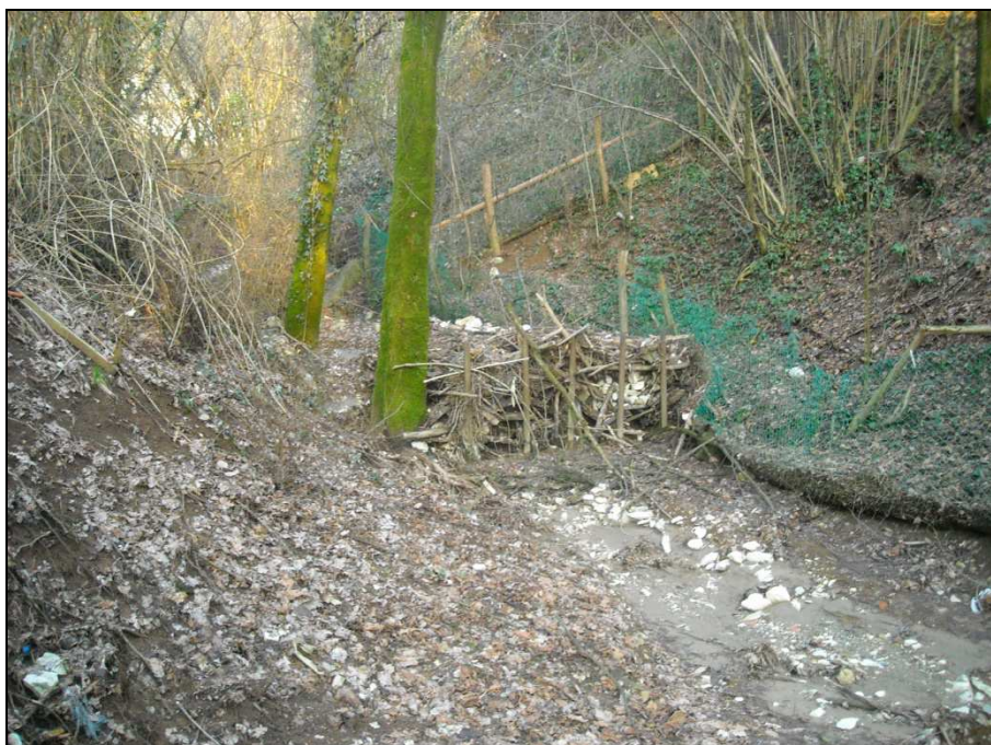
A valle del cono di depositi il corso d'acqua si incassa nelle formazioni rocciose e riduce notevolmente le sue dimensioni fino a giungere alla tombinatura a monte del capoluogo (sottodimensionata nei confronti di eventi meteorici intensi). Si notino nel talweg i depositi clastici trasportati dalle acque sino all'imbocco della successiva tombinatura.
