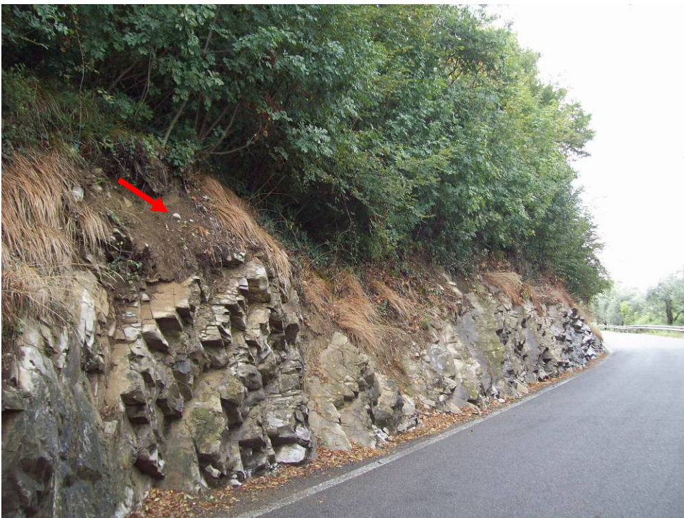
Foto 22: al contatto fra depositi detritici e substrato si osservano talvolta piccole cavità che in particolari periodi piovosi si comportano da risorgive idriche, con possibilità di piccoli flussi di detrito (si veda paragrafo 10.2 della relazione)
