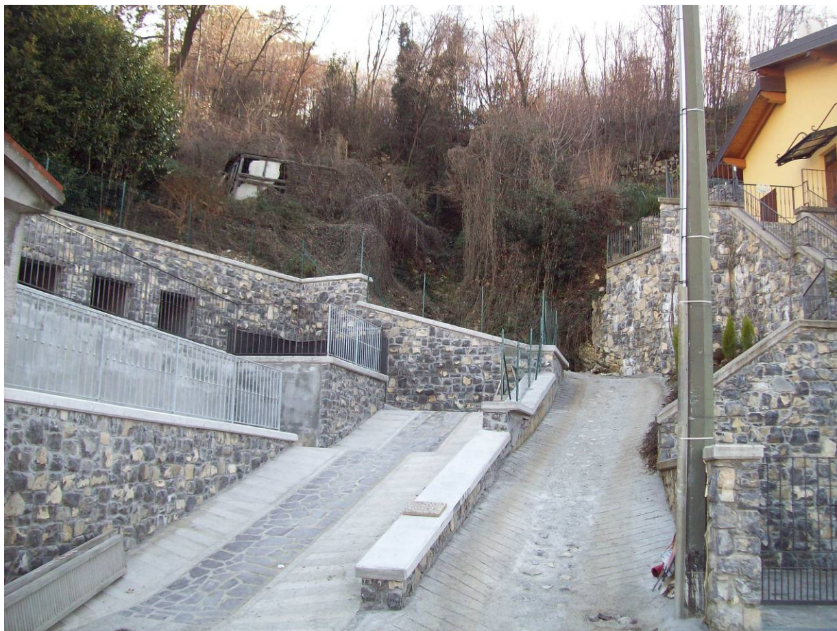
Foto 25 : punto di particolare criticità idraulica a causa di interruzione della continuità dell'impiuvio (Rio di Carnole, strada per Siviano)
