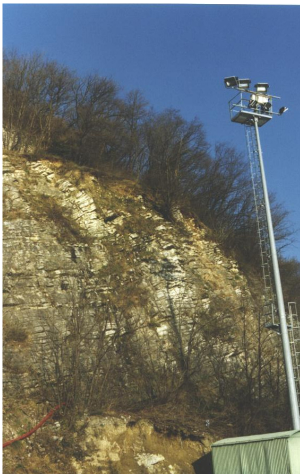
Foto 11: parete con elevata propensione al crollo
