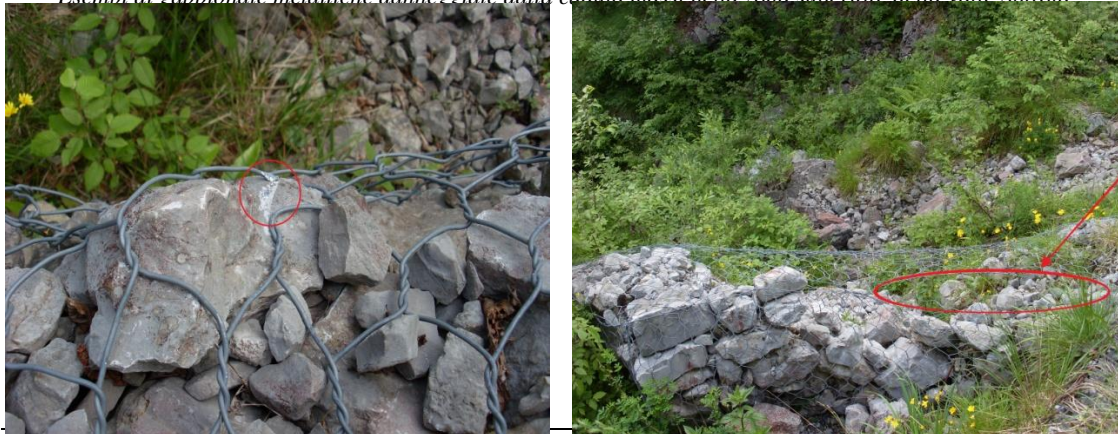
Esempi di gabbionate metalliche danneggiate dalla caduta massi nella zona superiore della Valle Spirola
