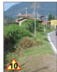
N. 10-SCARPATA AL MARGINE DELLA CARREGGIATA NON PROTETTA
