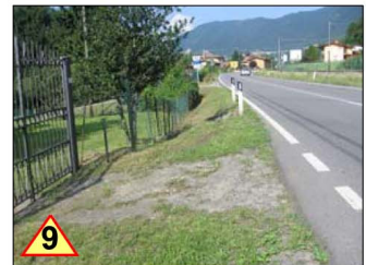
N. 9-SCARPATA AL MARGINE DELLA CARREGGIATA NON PROTETTA
