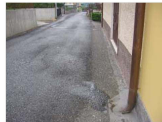
foto n.1 ERRATO SMALTIMENTO ACQUE METEORICHE
