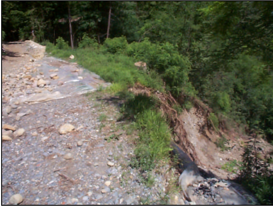
Foto n. 33 – Frana d scivolamento in località Ca Bianca all'interno della Valle del Ferro
