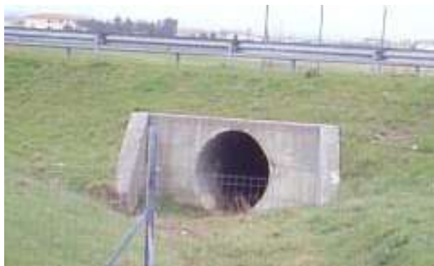
Figura 7: Tunnel di drenaggio delle acque che può svolgere anche funzione di attraversamento faunistico. M. Dinetti da Rapporto ISPRA 87/2008
