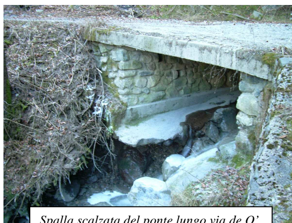
Spalla scalzata del ponte lungo via de O'
