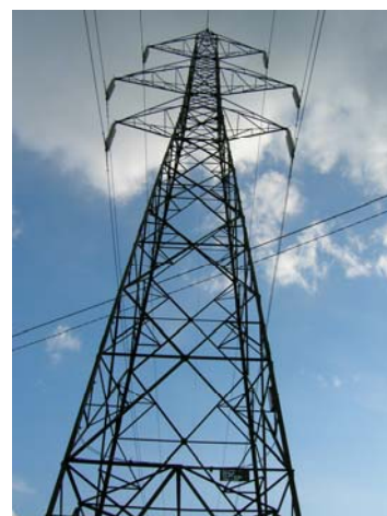
elettrodotto ad alta tensione
