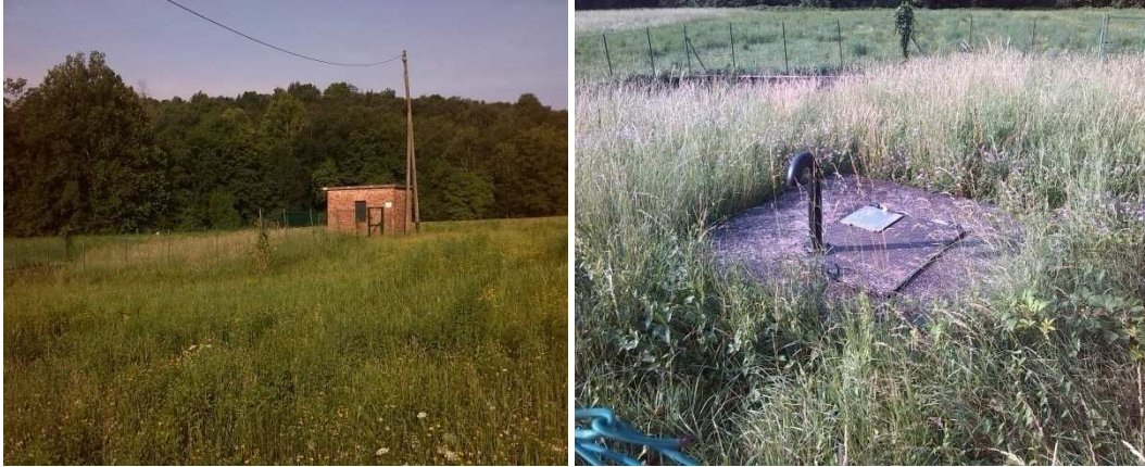
Figura 17- Pozzo idropotabile “Prati Molini: area di tutela assoluta e presa
