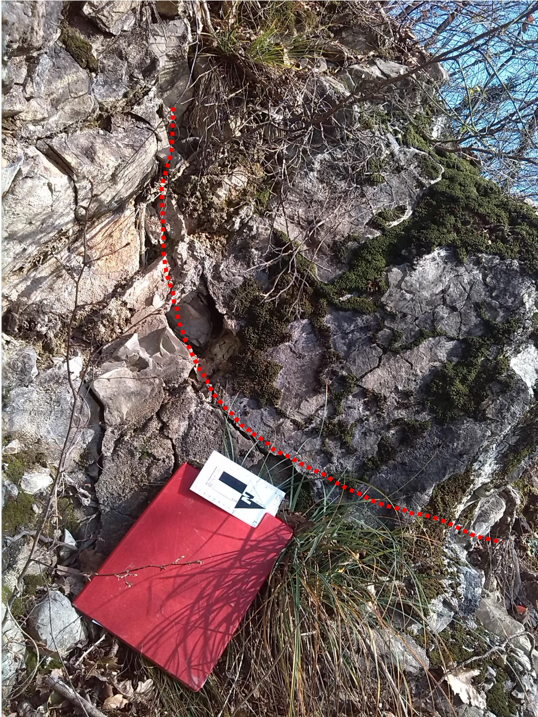
Figura 9-Stato fessurativo degli ammassi rocciosi lungo la scarpata
