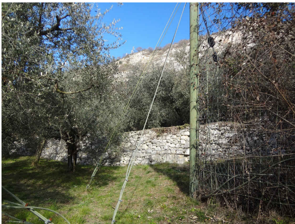
Figura 44 – Vista terrazzi antropici e reti paramassi presenti nell'area omogenea A, nell'area caratterizzata da presenza di uliveto.
